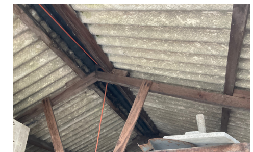
ኣስቤስቶስ ዘለዎ ኣብ ጋራጅ ዚርከብ ናሕሲ ቀጸላ ስሚንቶ
