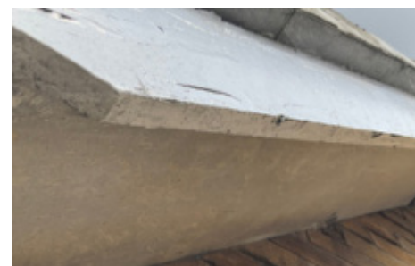
Placa de cimento-amianto para o telhado
