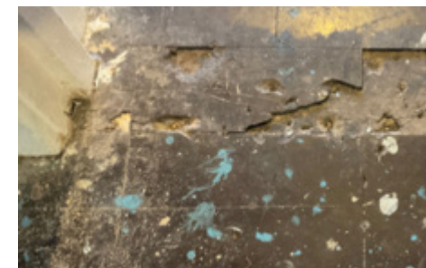
Amianto contendo ladrilhos e adesivos betuminosos
