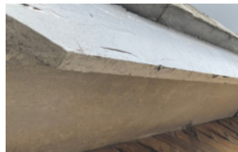
Asbestcemenčio sofito plokštė ant stogo
