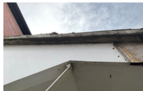
Asbesto turinčio cemento paklotas po stogeliu
