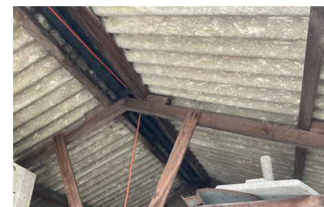
Pokrycie dachowe garażu z cementu zawierającego azbest
