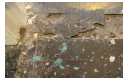
Płytki podłogowe i klej bitumiczny zawierające azbest
