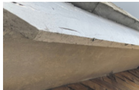
石棉水泥拱腹板到屋顶
