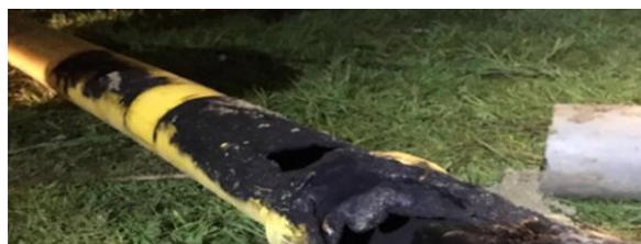
Foto's: door zoutzuurgas aangetaste gasleidingen
