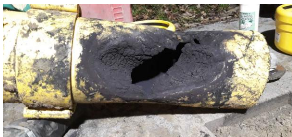
Foto: door zoutzuurgas aangetast gascomponent
